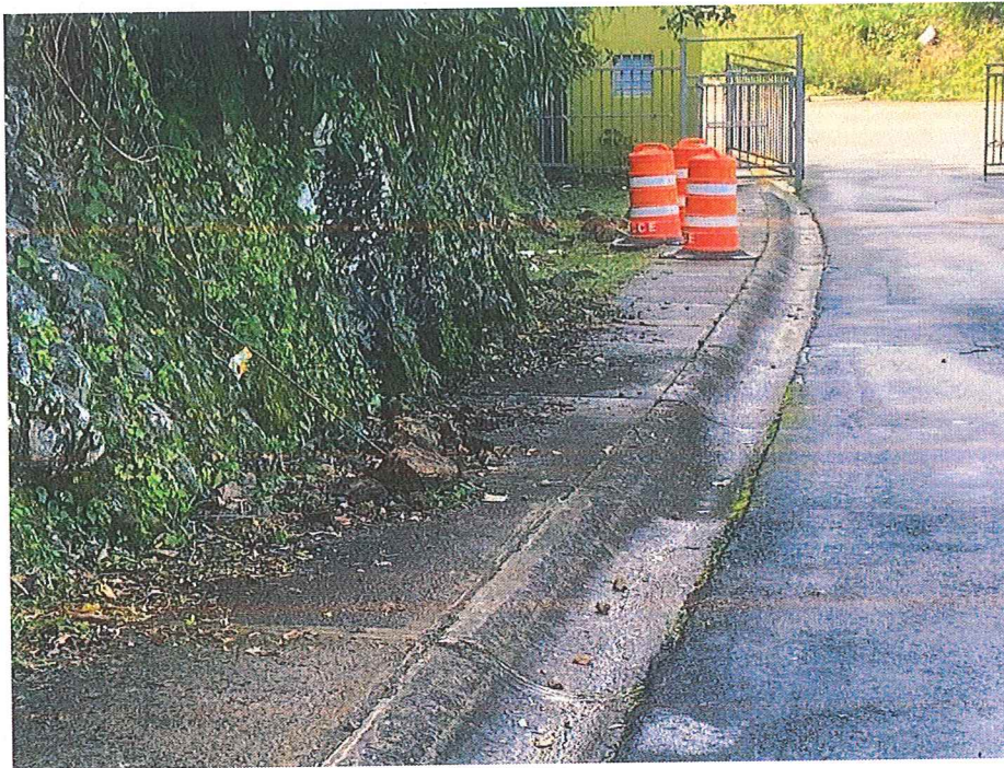
Foto 2: Se observaron unas rocas que cayeron del talud sobre la acera en la entrada de la escuela que deben ser removidas antes de comenzar las clases.
